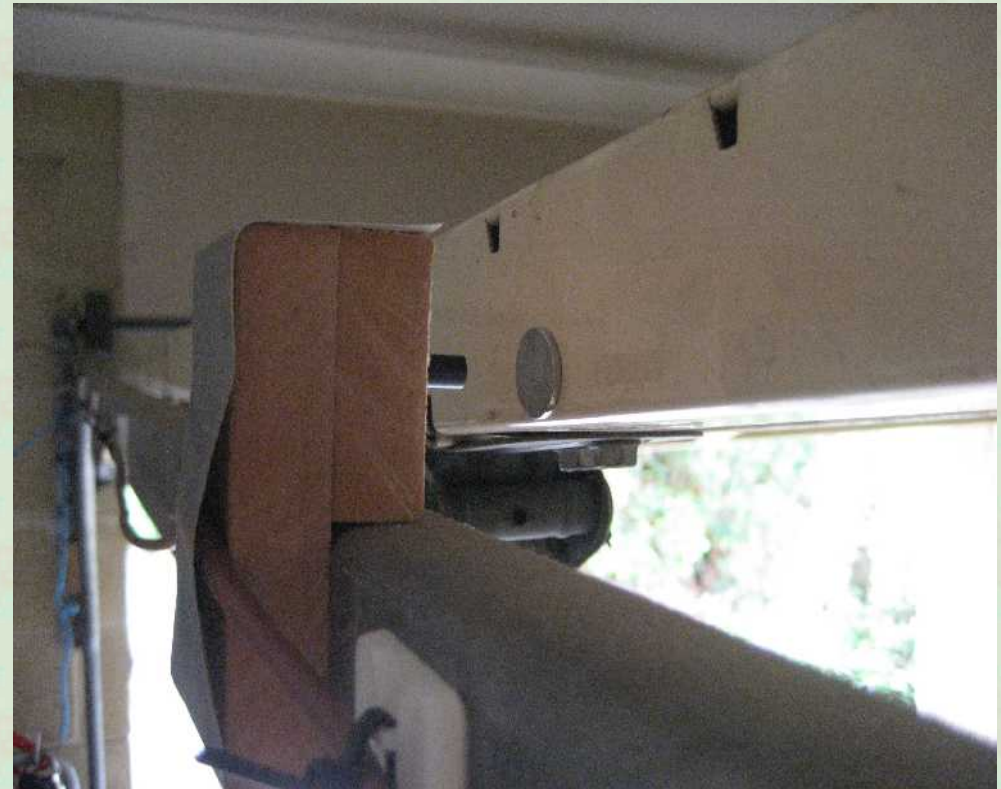
Reed Switch Rare-Earth Magnet actuator on door
